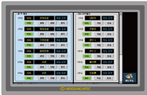
환경관리 운전화면 (스크린 터치 조작) · 자동, 수동운전 · 작동결과 확인
